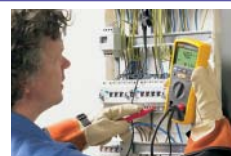
Проверка изоляции в распределительном щите
